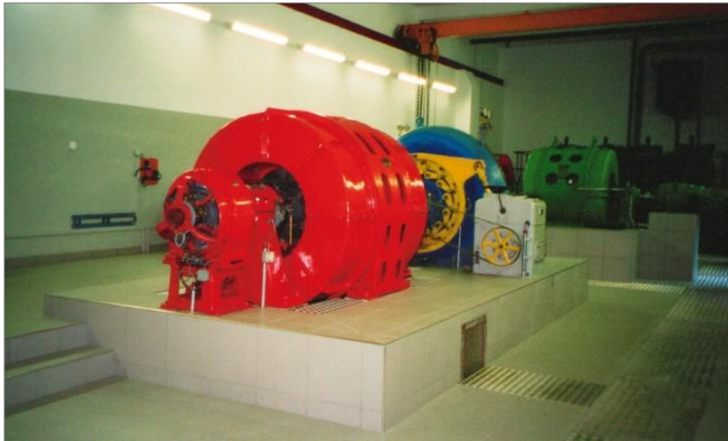
Ouvra electrica Clemgia, Scuol: halla da maschinas
